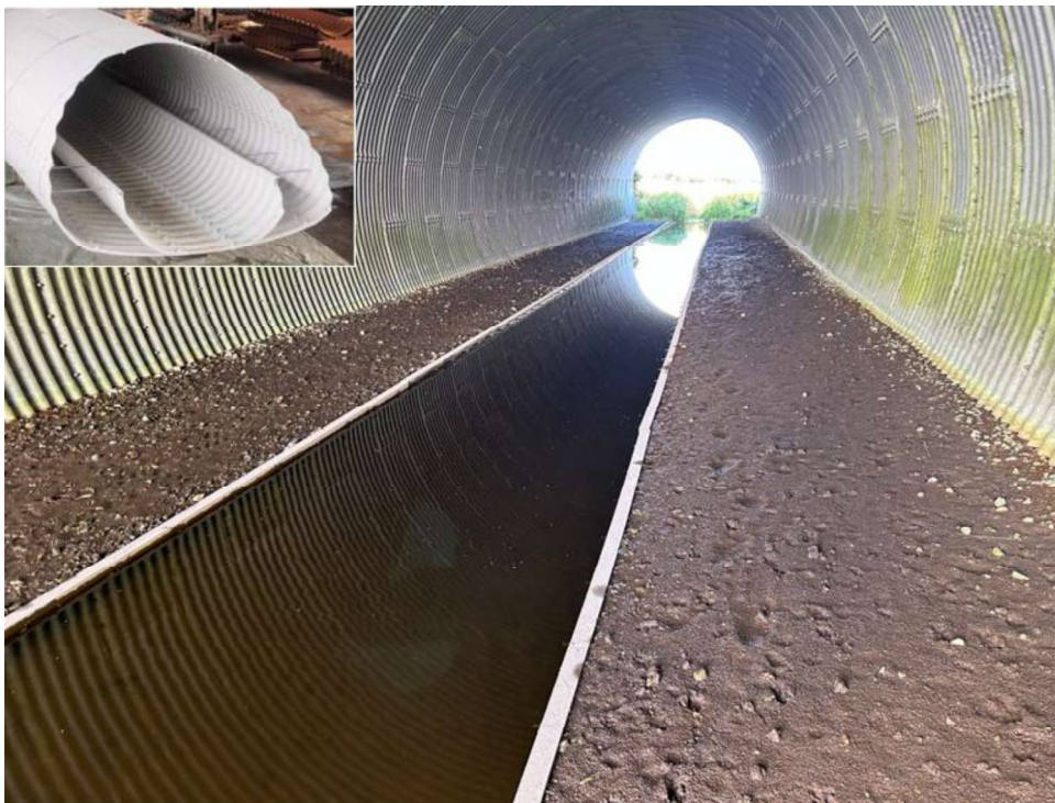
Figur 1-6 Eksisterende stålørundersøring ved Oddesundvej. Øverst venstre hjørne ses stålørkonstruktion.
